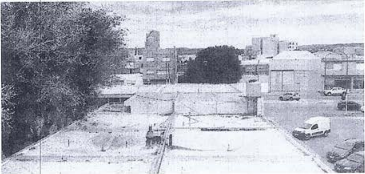
CAÑO DE GAS QUE COINCIDE CON VIGA CENTRAL DE LA CUBIERTA DEL SUM
